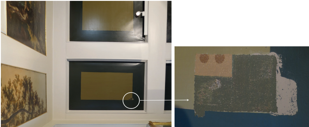
36. In strijklucht tekenen zich onder de huidige verflaag de contouren af van de cartouche-schildering van in of kort na 1895 (blauw) en het deel hiervan dat in 1972 door Kurvers is vrijgelegd (rood) (a). In of kort na 1895 ingebracht plafonddoek in de noordoostelijke cassette (hoek deur en raam). De schildering is in 1957 en nogmaals in 1972 overschilderd. Een kleurvenster (gemaakt in 2005 door Office for Architectural Paint Research & Conservation) toont het okergele vak met rode stippe lijn en het donkergroene kader van de schildering uit 1895 of kort erna (b). Foto's: From Isolation to Coherence
